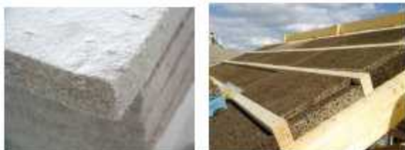
Fig. Nº 03. Techo con aislamiento térmico de papel reciclado.
